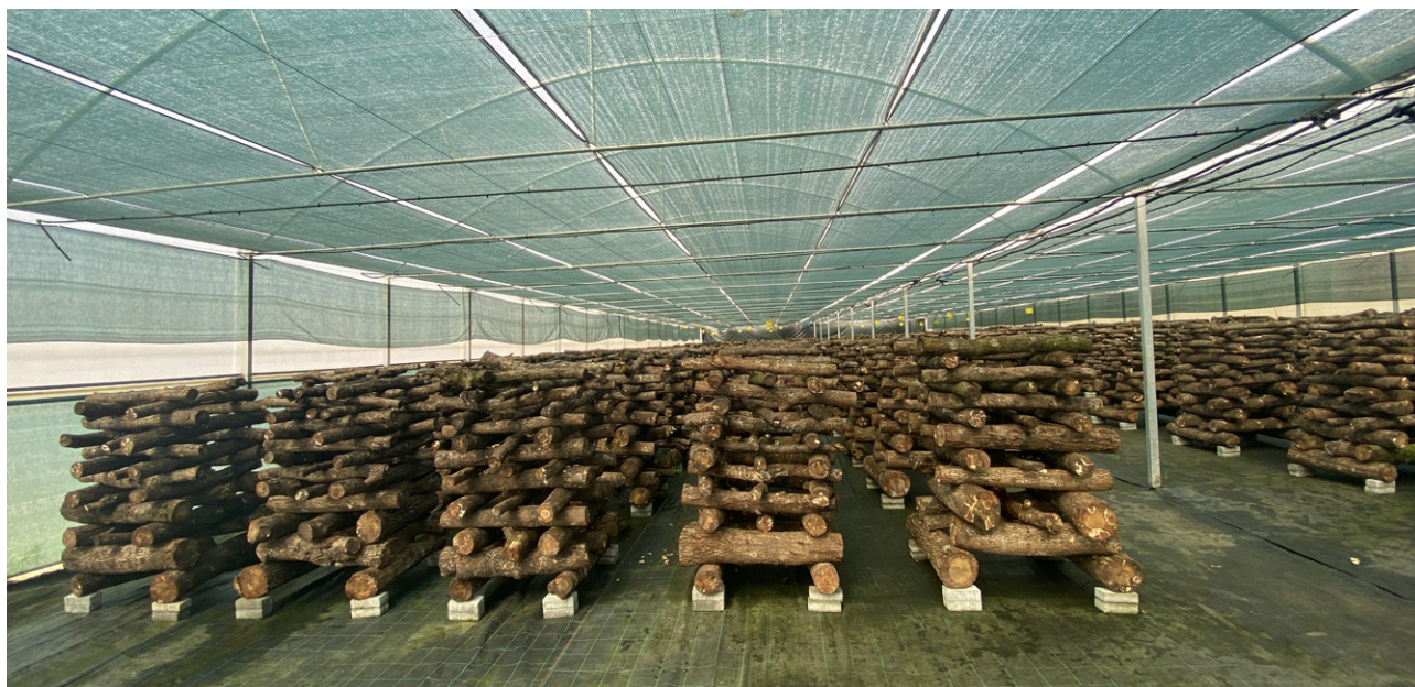
Figura 5. Sistema de microaspersão instalado no topo da estufa na Quinta do Pulo, na União de Freguesias de Atães e Rendufe do concelho de Guimarães.
